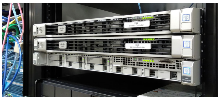
図2 無線LANコントローラ Cisco WLC552
