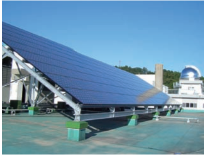
屋上に設置されたパネル
